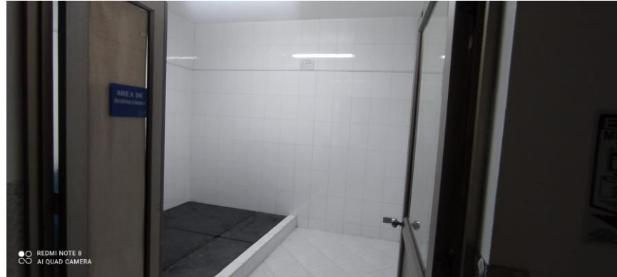
Figura 5 y 6. Centro de acopio temporal de residuos peligrosos
